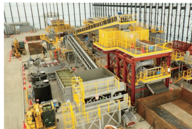
中間貯蔵施設内分級施設(大熊町)
