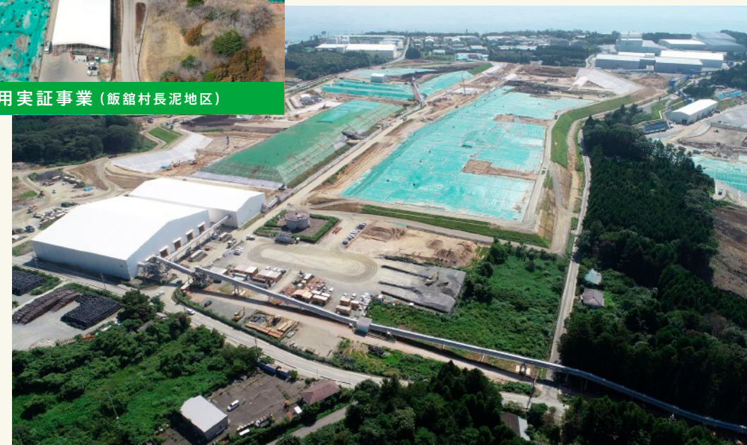
中間貯蔵施設（大熊町・双葉町）
